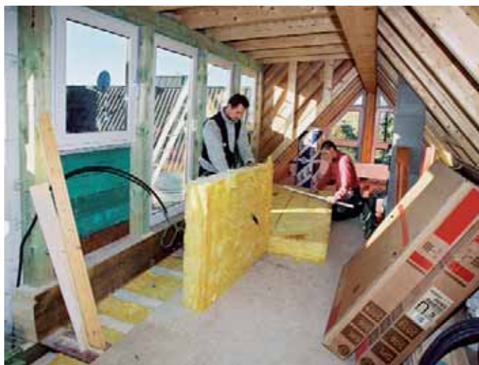
Laut EnEV 2009 sollen nun auch oberste Geschossdecken unter bestimmten Voraussetzungen gedämmt werden. (Foto: LBS)
