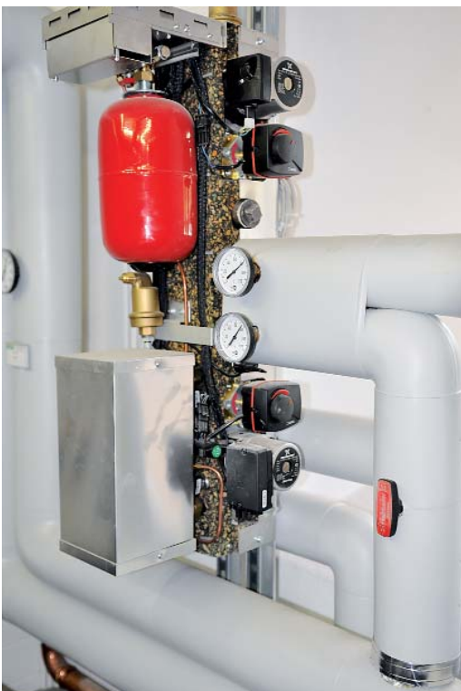
Das entkleidete Wärmeverteilmul Q 40. Unten die silberne Box ist der Wärmetauscher, der die Kühlwassertemperatur des Motors an den Heizkreis übergibt.
