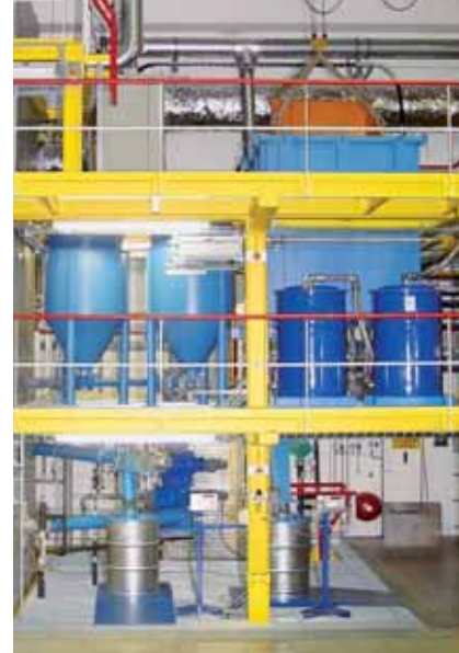
Anlage der Choren Industries in Freiberg/Deutschland für eine BTL-Produktion (Biomass to Liquid) von 15.000 Tonnen jährlich. Das reicht gerade mal für 5.000 Heizungen.
